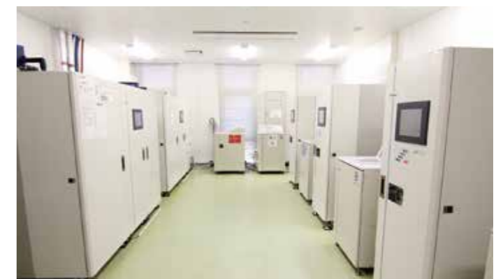
透析液のクリーン化を目指した水処理システムを構築
